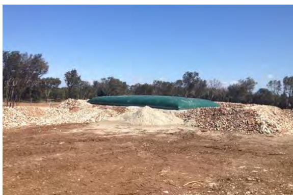
Réserve de 120 m 3 d'eau pour la lutte contre l'incendie sur l'emprise du projet
